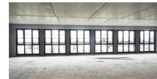
Markant von Anfang an: Schon im Rohbau ist die charakteristische Fensterform erkennbar.
